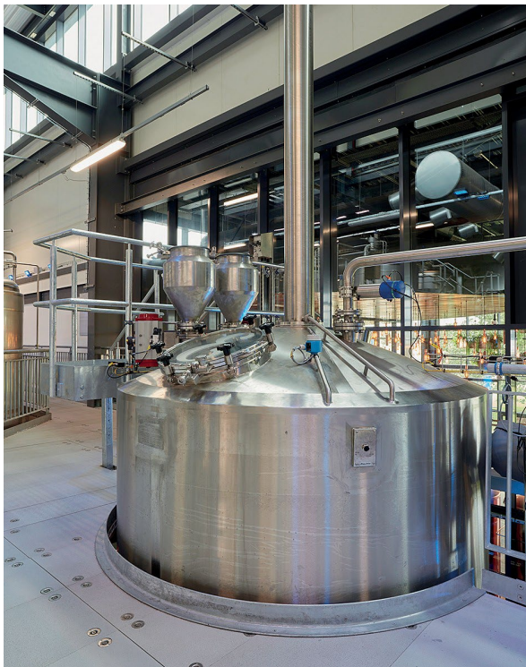
Варочный котёл на пивоварне Фото: Neil Robinson
